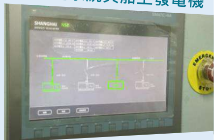
並聯岸電系統與船上發電機
