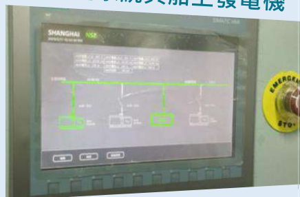
並聯岸電系統與船上發電機
