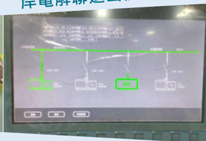
岸電解聯退出供電系統
