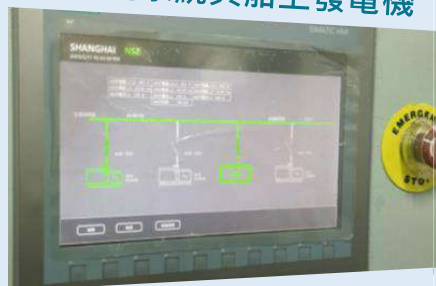
並聯岸電系統與船上發電機
